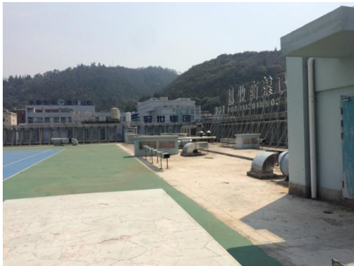
楼顶烟道及风机排气口
