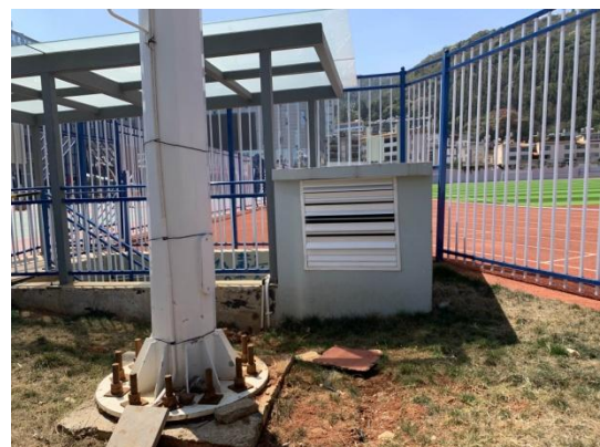
地下车库排气口
